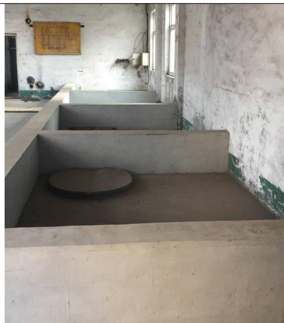
依托的一电厂危废车间
